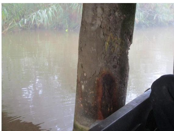
Wapeningscorrosie, scheurvorming en holle delen aan binnenzijde van paal.
