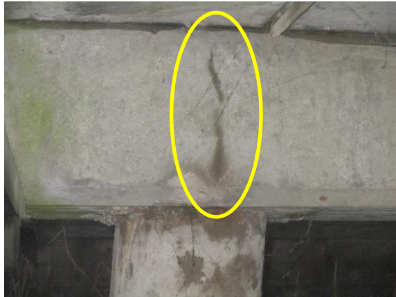
Scheurvorming in betonnen steunpunt aan zuidzijde van brug.
