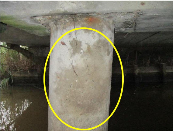
Holle delen met scheurvorming in betonnen paal
