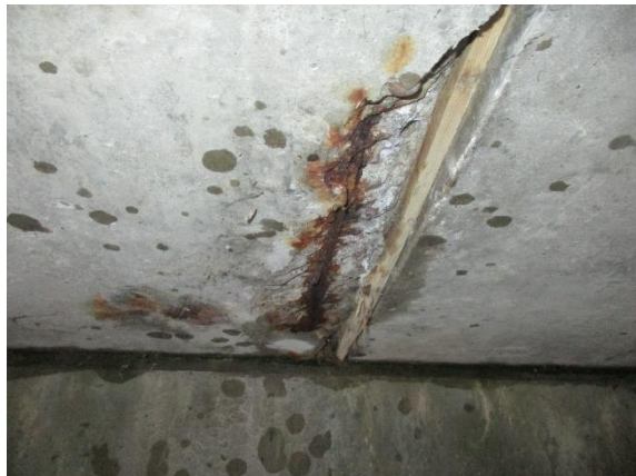
Wapeningscorrosie aan onderzijde brugdek.
