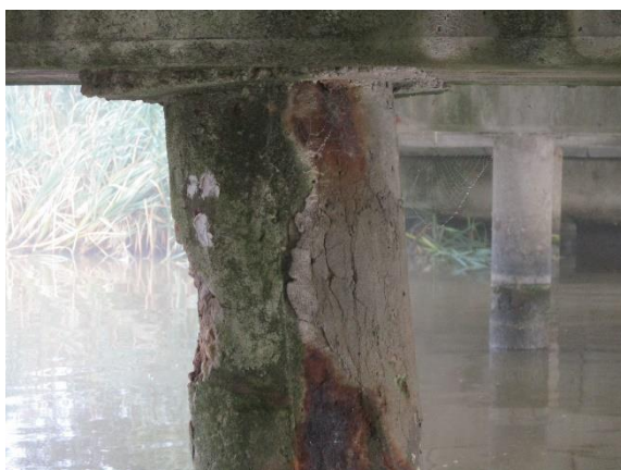
Holle delen, scheurvorming, wapeningscorrosie en afbrokkelende delen aan paal aan buitenzijde (zuidzijde) van de brug.
