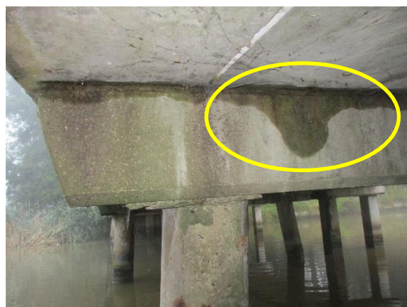
Lekkage sporen aan onderzijde rijdek bij de steunpunten, bij vrijwel alle steunpunten aanwezig.
