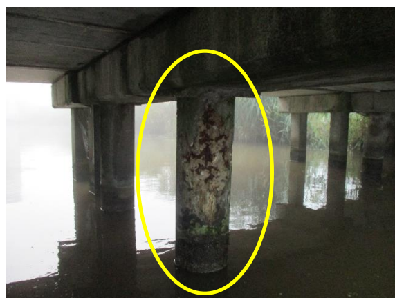
Gevorderde wapeningscorrosie met afgebrokkelde delen aan middelste paal bij steunpunt aan zuidzijde van brug.
