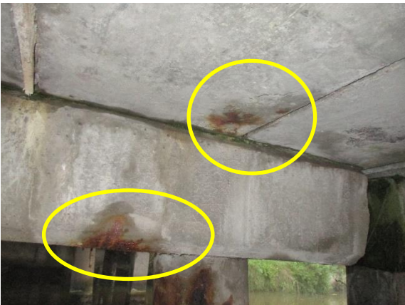
Wapeningscorrosie aan onderzijde steunpunt en rijdek.
